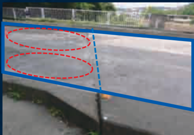
施工前(わだち、亀裂)
